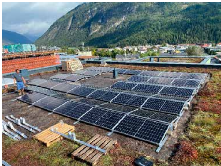
PV Anlage am Dach der Mittelschule Unterstadt.
