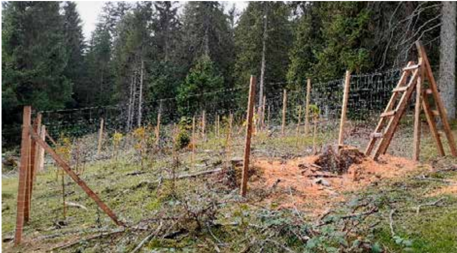
Einer der zehn installierten wilddichten Zäune.
